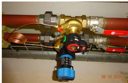
Vannes d'équilibrage en pieds de colonne de chauffage Lycée Chagall à Reims
