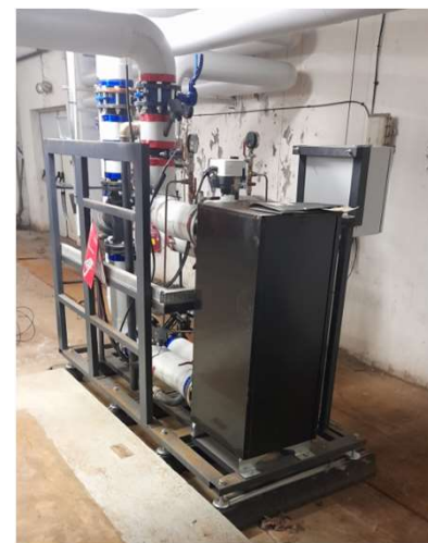
Echangeur de chaleur Lycée Julie DAUBIE - Rombas
