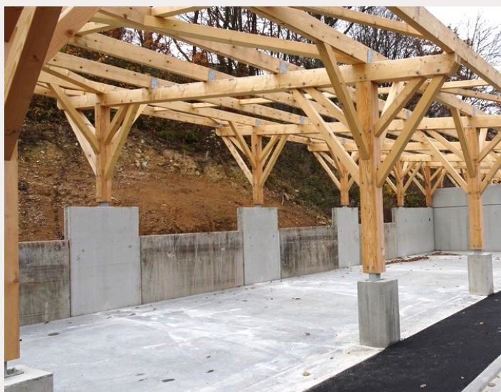
Les murs sont utilisés comme des panneaux de remplissage auto-portants. 4 de ces murs sont intégrés entre des portions de prémurs supports des poteaux de charpente.
