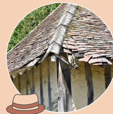
▲ Exemple de toiture mal entretenue pouvant provoquer une dégradation du torchis et de la structure bois en raison du ruissellement des eaux de pluie.
