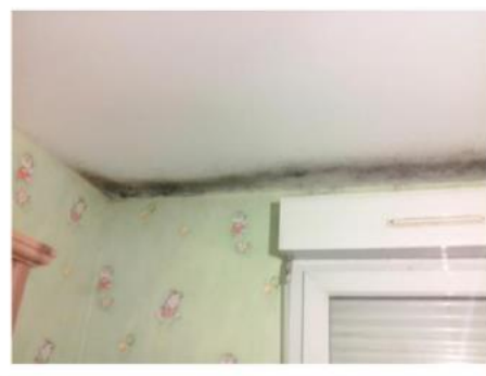
Moisissures sur le pont thermique d'un plancher
