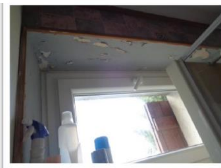
Dégradations des revêtements
