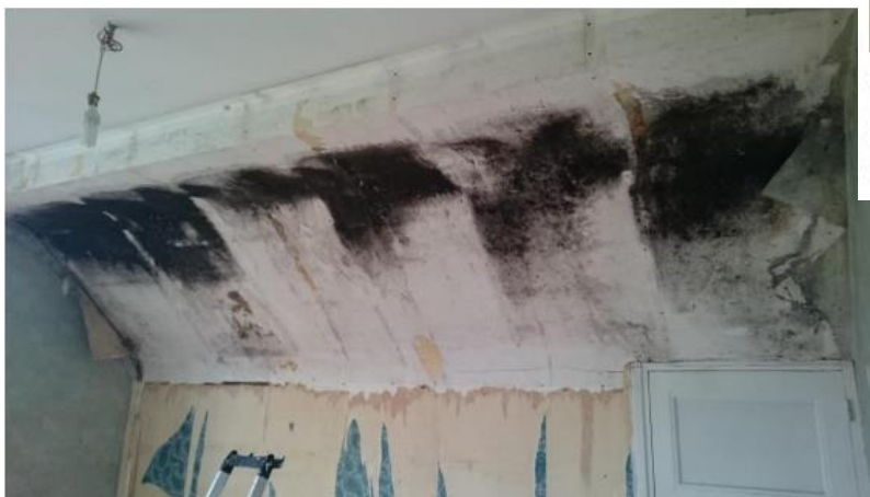
Moisissures sur la partie externe d'une toiture isolée par ITI. ©CMDL-2019
