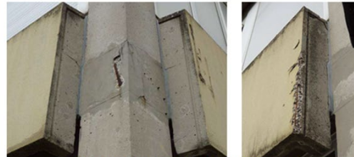
Désordres sur les poteaux et les bandeaux en béton préfabriqué
