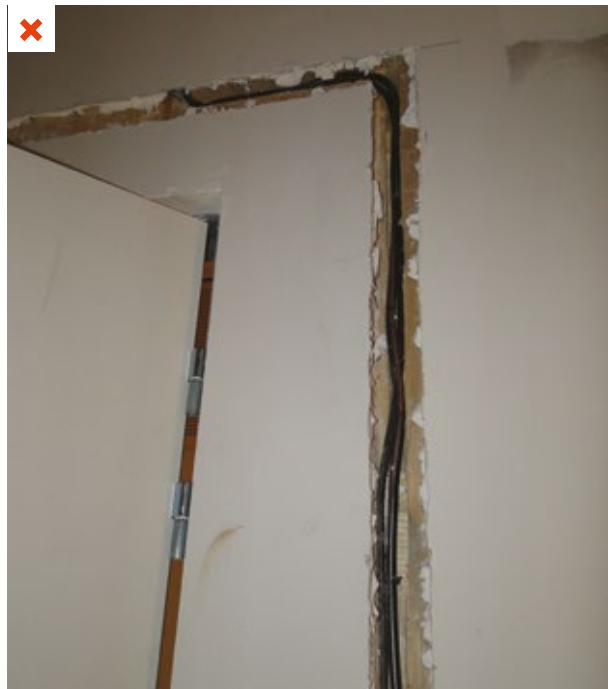
En phase chantier, une saignée a dû être réouverte pour passer des câbles de désenfumage qui avaient été oubliés
