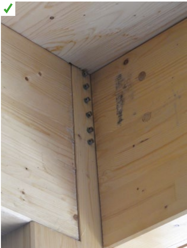
Des sondes sont positionnées à différentes profondeurs d'une poutre en bois afin de contrôler l'évolution de son humidité
