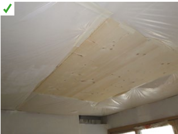
Des bâches de protection vis-à-vis des projections de peinture sont mises en place sur un plafond en bois destiné à rester visible
