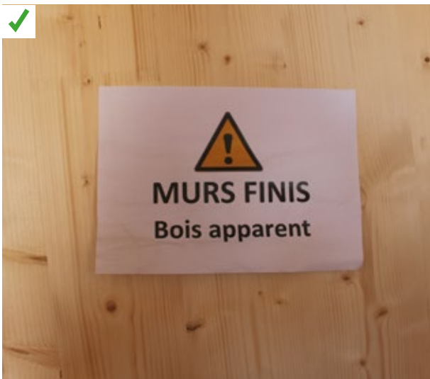
Alerte à destination de tous les compagnons sur la présence de murs finis en bois apparent
